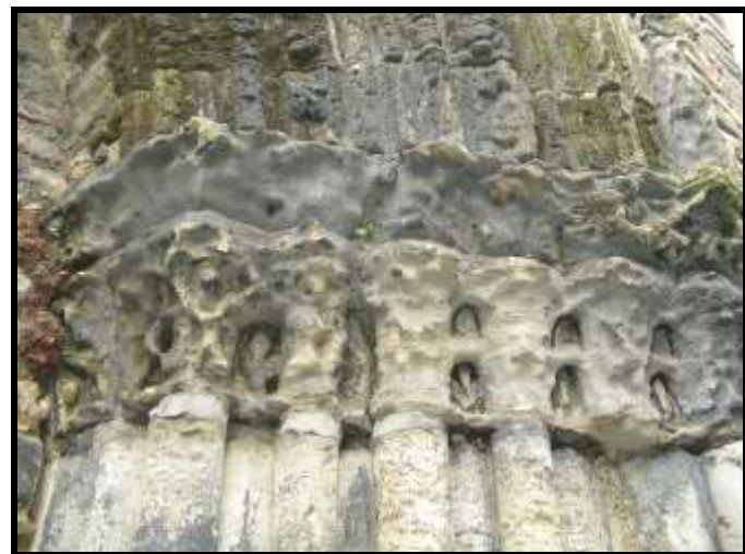
Fig. 90 Chapiteaux de la façade du prieuré très abîmés.
